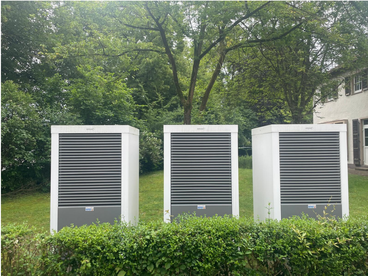
Außengeräte am Trainingscenter der Komatsu Germany GmbH in Düsseldorf/Komatsu GmbH
